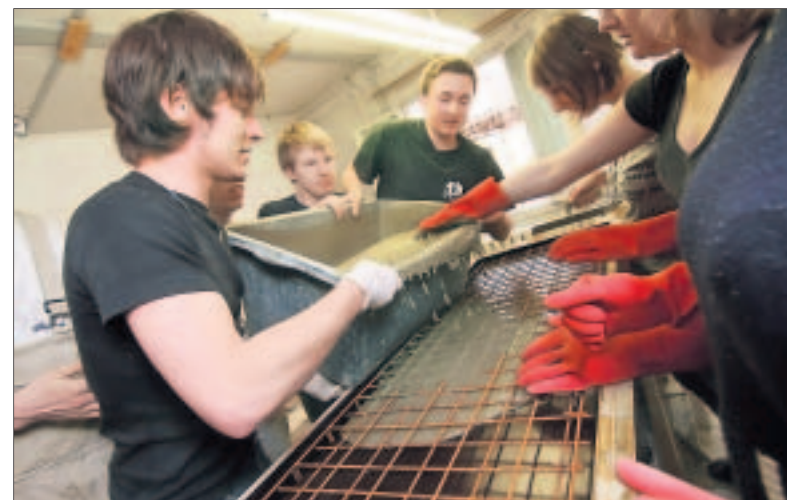
Das ganze Team ist notwendig, wenn der frische Beton in die Holzform gegossen wird.
